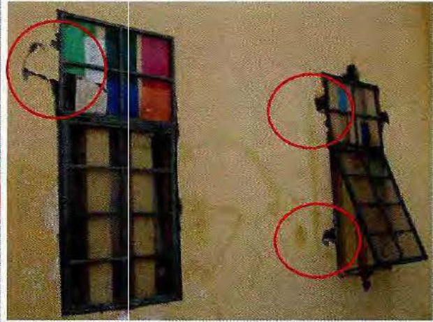
Fotografía N°2: Daño en rasgo de ventana de fachada de casa N°2, Centro Metropolitano Norte Til-Til, 23 de marzo de 2015.
