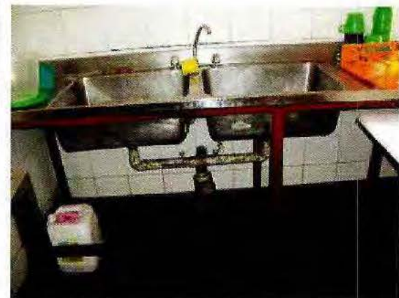
Fotografía N°23: Estructura lavaplatos con oxido y sin protección anticorrosiva en algunas áreas, casa N°3.
