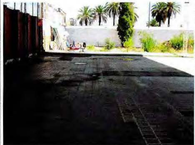
Fotografía N°16: Se observa pavimentos de multicancha en mal estado.
