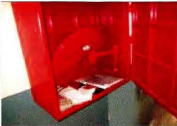
Fotografía N°13: Ausencia de manguera de gabinete de red húmeda, casa N°7 no utilizada, Centro Metropolitano Norte Til-Til, 23 de marzo de 2015.
