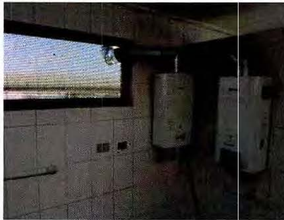
Fotografía N°15: Calefont al interior de los baños, CIP-CRC San Joaquín, 18 de marzo de 2015.
