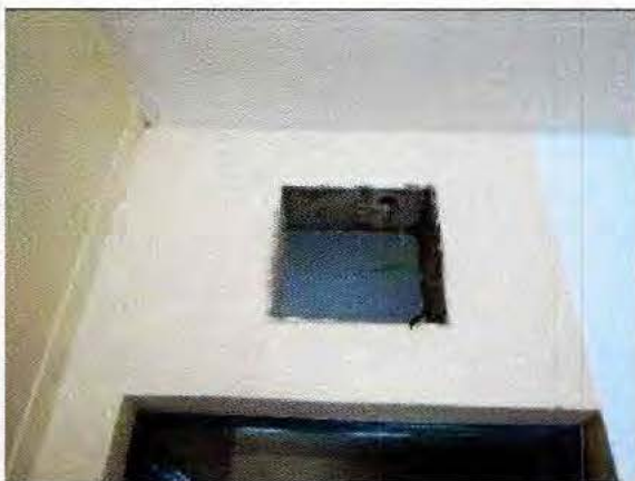
Fotografía N°15: Daño en las instalaciones eléctricas, casa N°7 no utilizada Centro Metropolitano Norte Til-Til, 23 de marzo de 2015.
