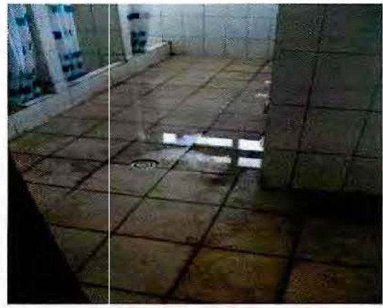
Fotografía N°14: Presencia de moho en las paredes del baño, CIP-CRC Centro Metropolitano Norte de Til-Til, 26 de marzo de 2015.
