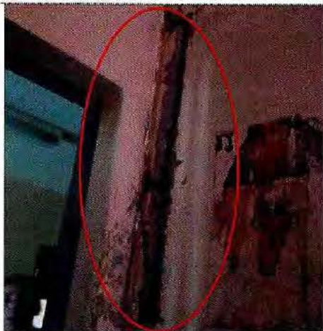
Fotografía N°5: Daño en rasgo de puerta casa N°5, Centro Metropolitano Norte Til-Til, 23 de marzo de 2015.
