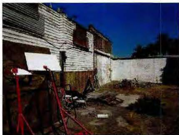
Fotografía N°1: Acumulación de escombros en parte posterior a multicancha.
