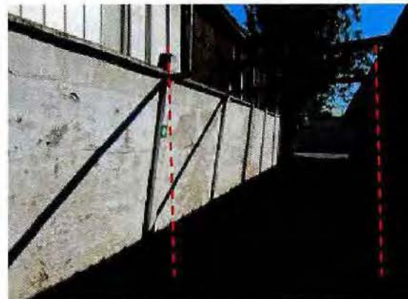
Fotografía N°12: Cierre perimetral poniente, con problemas de estabilidad, requiere refuerzos horizontales anclados a alero.
