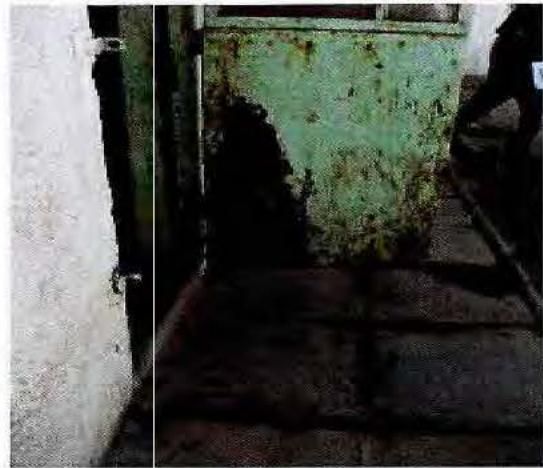
Fotografía N°8: Puertas de habitaciones de unidad de atención especial con altos niveles de oxidación y pérdida de material.
