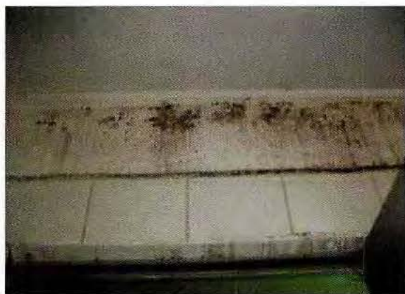
Fotografía N°11: Presencia de moho en las paredes del baño, CIP-CRC Santiago, 31 de marzo de 2015.
