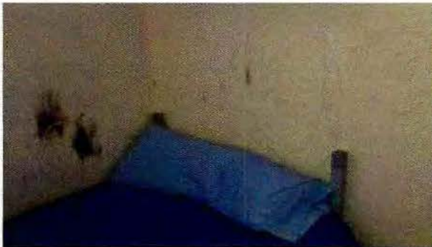
Fotografía N°11: Muros rayados y sin pintura en dormitorios casa N°3.
