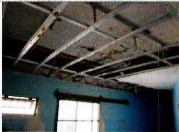
Fotografía N°19: Cielos desprendidos en acceso jóvenes primer piso..
