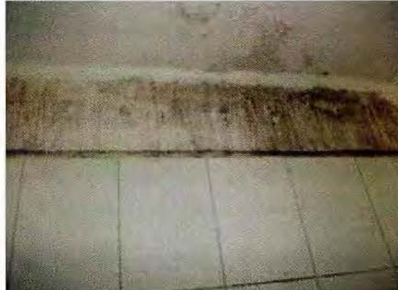
Fotografía N°12: Presencia de moho en las paredes del baño, CIP-CRC Santiago, 31 de marzo de 2015.
