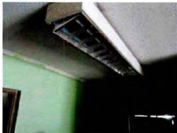
Fotografía N°29: En términos generales se aprecian problemas en instalaciones eléctricas a modo de ejemplo iluminación sector Gendarmería de Chile.
