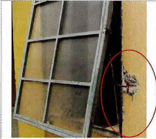
Fotografía N°1: Daño en rasgo de ventana de fachada de casa N°2, Centro Metropolitano Norte Til-Til, 23 de marzo de 2015.
