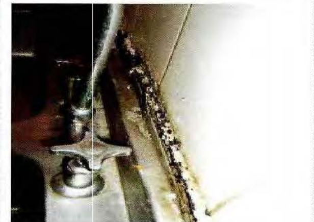
Fotografía N°24: Presencia de hongo en lavaplatos de casa N°2.
