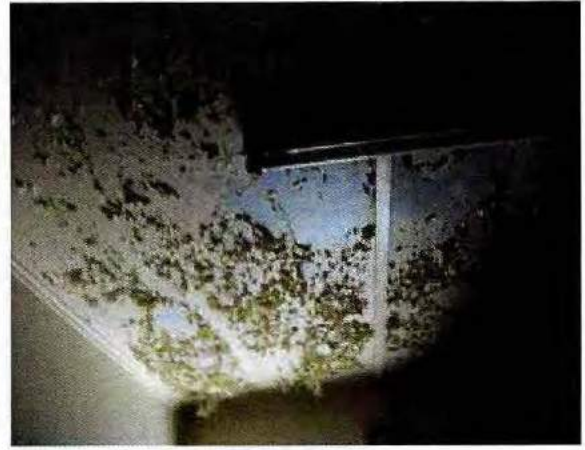
Fotografía N°2: Desprendimiento de pintura en baño destinado a Gendarmería de Chile.
