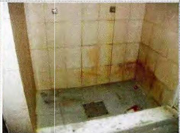
Fotografía N°6: Ducha con moho, casa 2, sector dormitorios, CIP-CRC San Bernardo, 16 de marzo de 2015.
