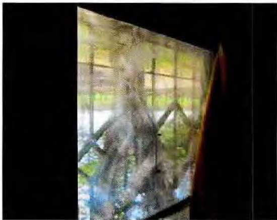
Fotografía N°5: Policarbonatos quebrados y rayados en biblioteca.
