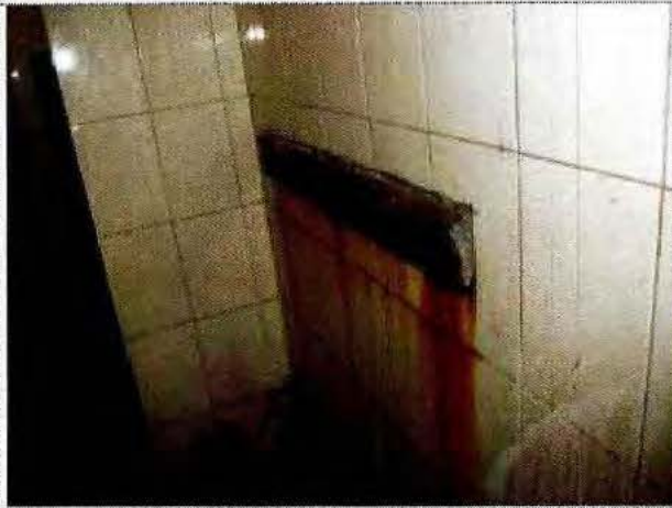
Fotografía N°7: Urinario con oxido, casa 4, sector dormitorios, CIP-CRC San Bernardo, 16 de marzo de 2015.
