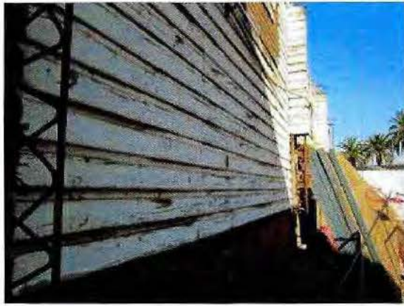
Fotografía N°13: Cierre perimetral sur con problemas de estabilidad.
