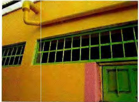
Fotografía N°18: Ventanas dormitorios en general todas las casas sin policarbonatos.
