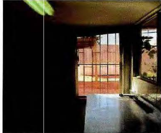
Fotografía N°16: Ventana cocina con marco en mal estado y sin malla mosquetera.
