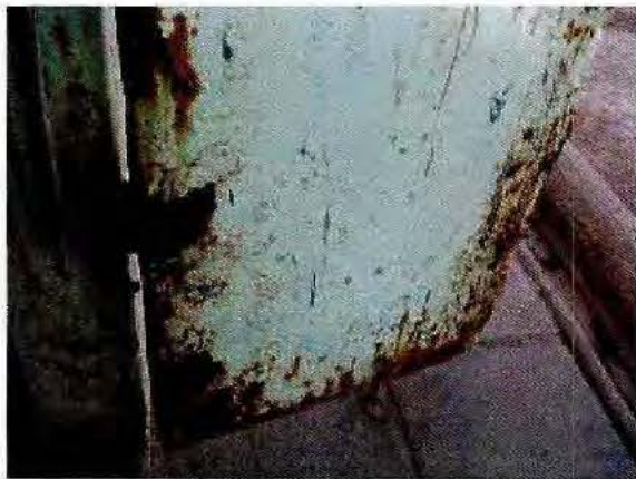
Fotografía N°9: Puertas de habitaciones de unidad de atención especial con altos niveles de oxidación y pérdida de material.
