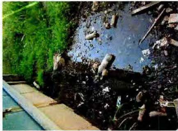
Fotografía N°1: Basura y pozas de agua, puerta anillo perimetral hacia calle Llico.
