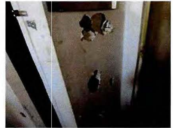
Fotografía N°12: Tabiques rotos en closet dormitorios para Gendarmería de Chile.
