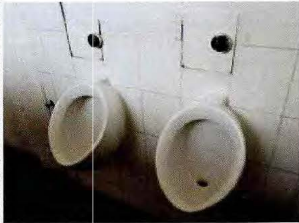
Fotografía N°14: Urinarios de casa N°2 sin funcionamiento, CSC La Cisterna, 30 de marzo de 2015.
