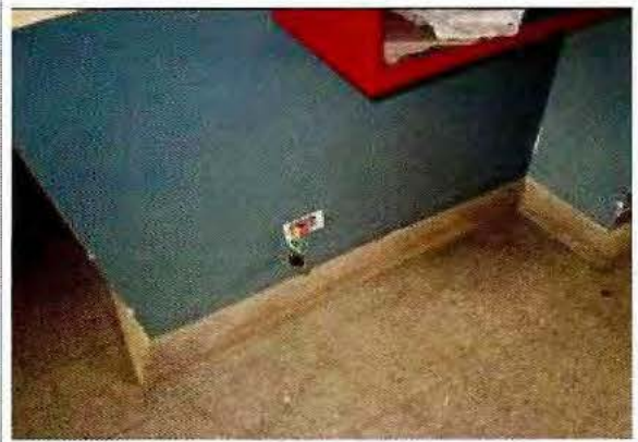
Fotografía N°14: Daño en las instalaciones eléctricas, casa N°7 no utilizada Centro Metropolitano Norte Til-Til, 23 de marzo de 2015.
