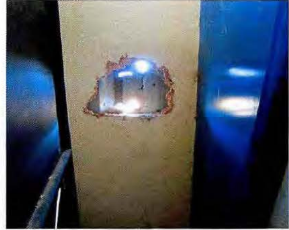
Fotografía N°2: Perforación en paneles gimnasio, CRC San Bernardo, 16 de marzo de 2015.
