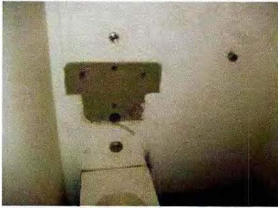
Fotografía N°7: Ausencia de lavamanos en baño no utilizado, casa N°2, Centro Metropolitano Norte Til-Til, 23 de marzo de 2015.
