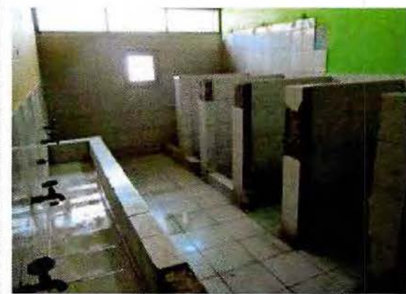
Fotografía N°27: Cerámicos desprendidos en baños casa N°8..
