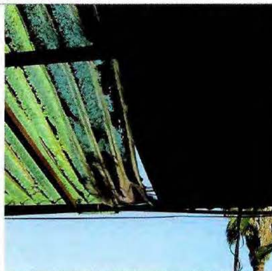
Fotografía N°4: Cubierta en mal estado en espacio de circulación entre casas N°s 2 y 3.
