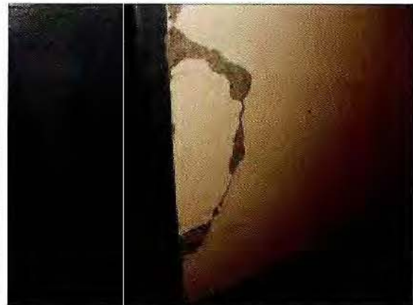
Fotografía N°6: Daño en muro de puerta casa N°7, Centro Metropolitano Norte Til-Til, 23 de marzo de 2015.
