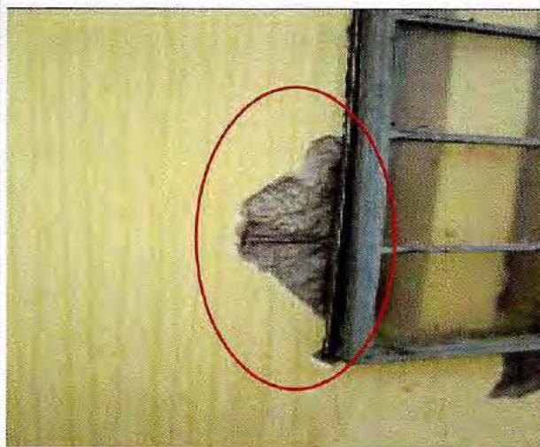
Fotografía N°3: Daño en rasgo de ventana de fachada de casa N°2, Centro Metropolitano Norte Til-Til, 23 de marzo de 2015.
