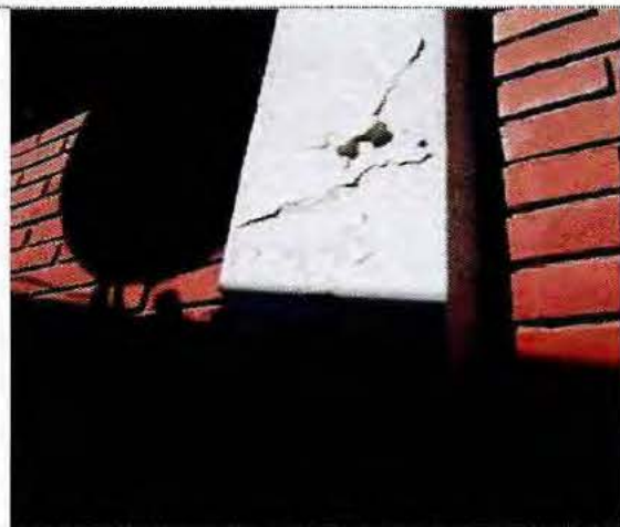
Fotografía N°8: Falta de mantención en pintura exterior a casas y sector comedor
