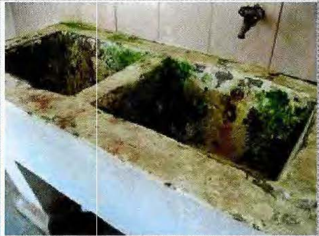
Fotografía N°4: Lavamanos con moho, casa 1, sector patio, CIP-CRC San Bernardo, 16 de marzo de 2015.
