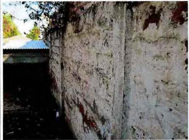
Fotografía N°14: Cierre perimetral norte con problemas de estabilidad.
