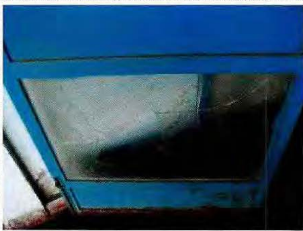
Fotografía N°13: Vidrio roto en puerta metálica de hall de instalaciones para Gendarmería de Chile.
