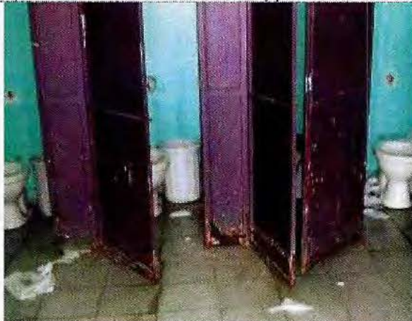
Fotografía N°11: Puertas metálicas de baños comunes casa N°3 con óxido y pérdida de material.
