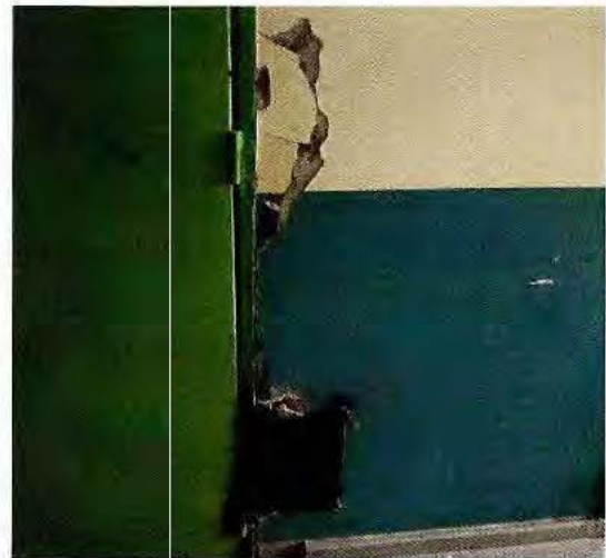
Fotografía N°4: Daño en rasgo de puerta casa N°3, Centro Metropolitano Norte Til-Til, 23 de marzo de 2015.
