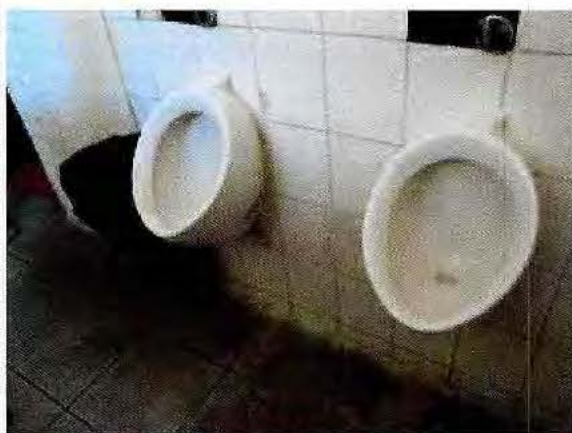
Fotografía N°15: Urinarios de casa N°3 sin funcionamiento, CSC La Cisterna, 30 de marzo de 2015.
