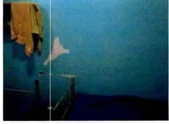
Fotografía N°10: Pintura muros deteriorada en dormitorios casa N°2.
