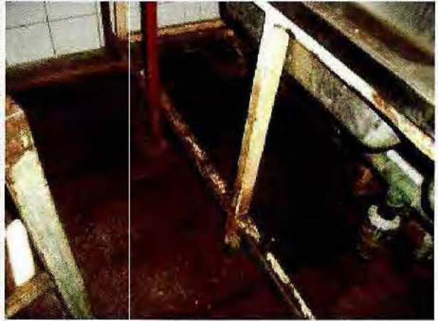
Fotografía N°22: Estructura lavaplatos con oxido y sin protección anticorrosiva en algunas áreas, casa N°2.
