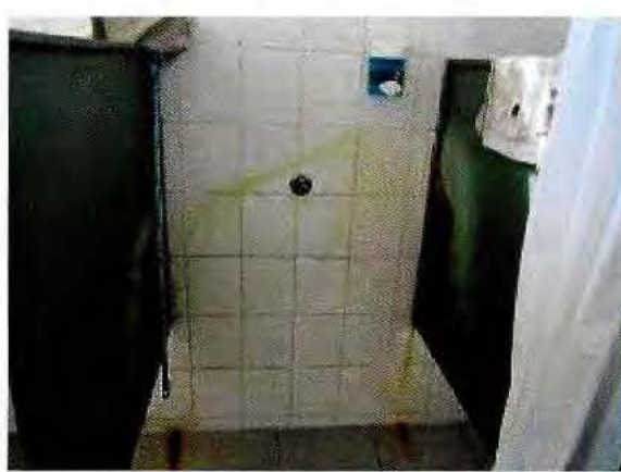
Fotografía N°6: Oxidación en elementos separadores de duchas de jóvenes en casa N°3.
