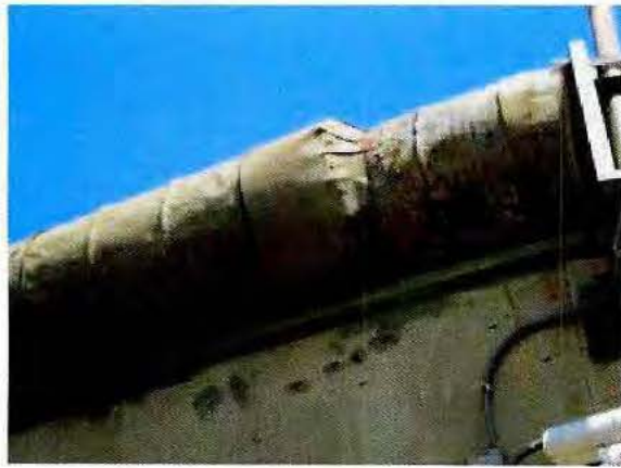
Fotografía N°11: Oxidación en tambores anti escalada muro perimetral.
