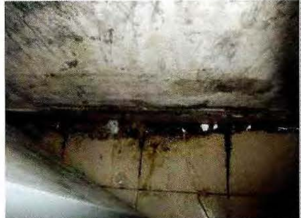
Fotografía N°2: Dormitorio con humedad y moho en pared colindante con duchas de baño, Centro Metropolitano Norte Til-Til, 26 de marzo de 2015.
