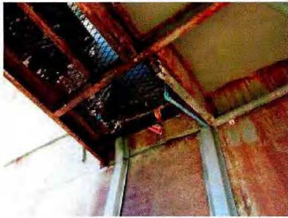
Fotografía N°9: Oxidación en base de garitas.
