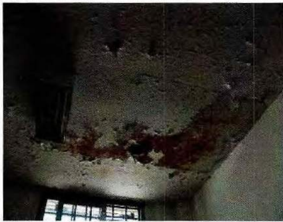
Fotografía N°3: Desprendimiento de pintura en baño de jóvenes varones.
