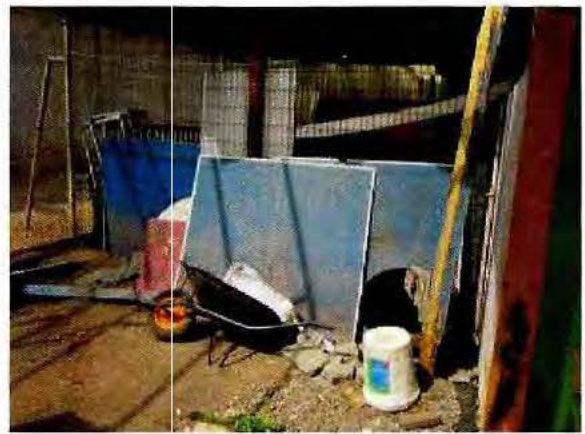
Fotografía N°6: Materiales de construcción acopiados en patio en casa N°7.
