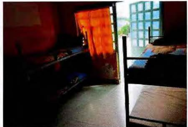
Fotografía N°20: Muros dormitorios casas N°1, con pintura deteriorada..
