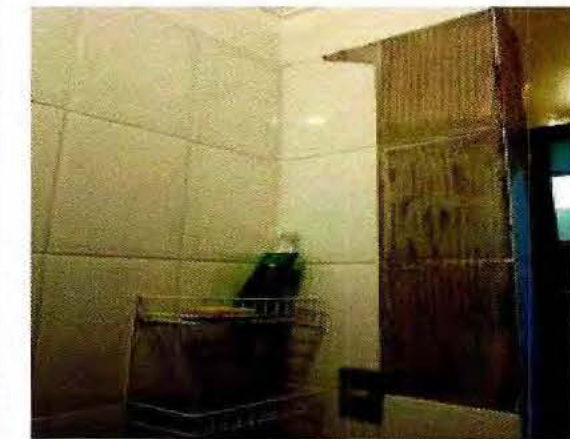
Fotografía N°23: Cerámico desprendido baño gendarmería primer piso.
