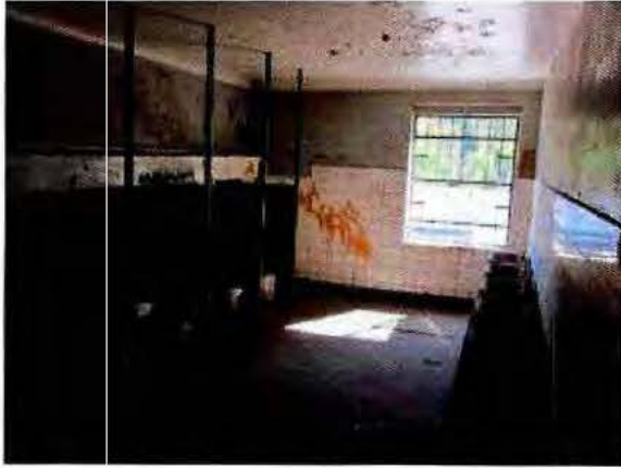
Fotografía N°15: Zona de baños segundo nivel casa central, no se encuentra operativa.
