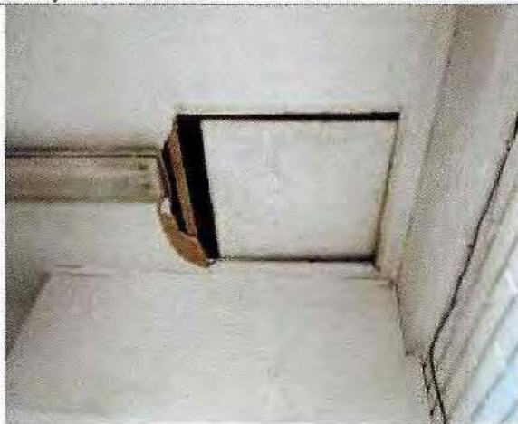
Fotografía N°9: Abertura en cielo falso de baño para minusválidos.
