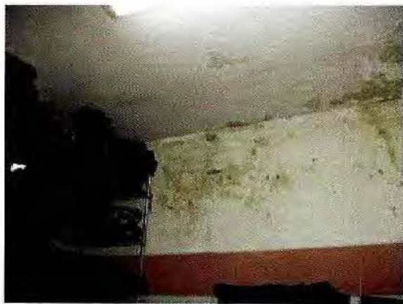
Fotografía N°15: Humedad en muros de bodega donde se almacenan las frazadas en sector lavandería.
