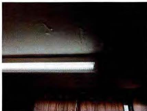
Fotografía N°10: Deterioro en cielo falso, oficinas casa área técnica.
