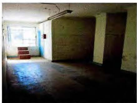
Fotografía N°6: Falta de aseo en sector de salida de emergencia segundo nivel, casa central.
