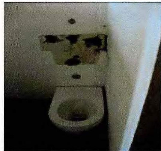
Fotografía N°10: Ausencia de lavamanos en baño casa N°7 no utilizado, Centro Metropolitano Norte Til-Til, 23 de marzo de 2015.
