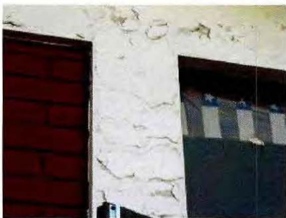
Fotografía N°7: Falta de mantención en pintura exterior a casas y sector comedor.
