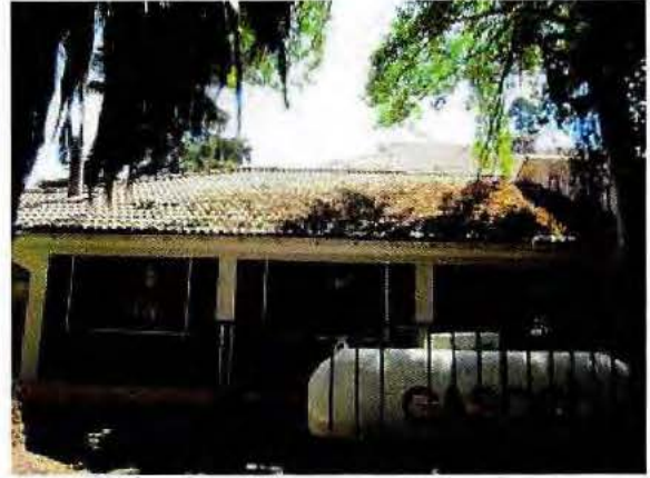
Fotografía N°2: Cubierta casa N°1 con hojas y ramas.
