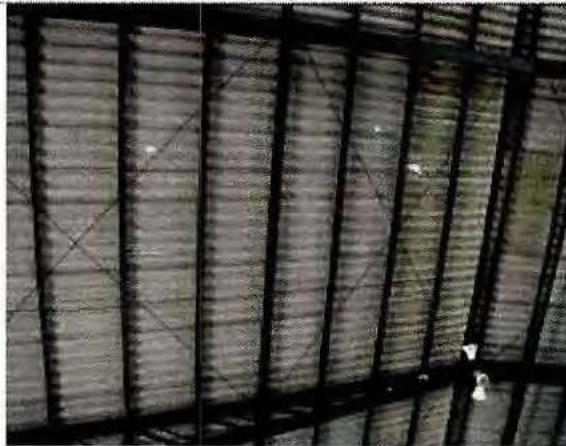
Fotografía N°21: Daño en cubierta de gimnasio, CIP-CRC Santiago, 31 de marzo de 2015.
