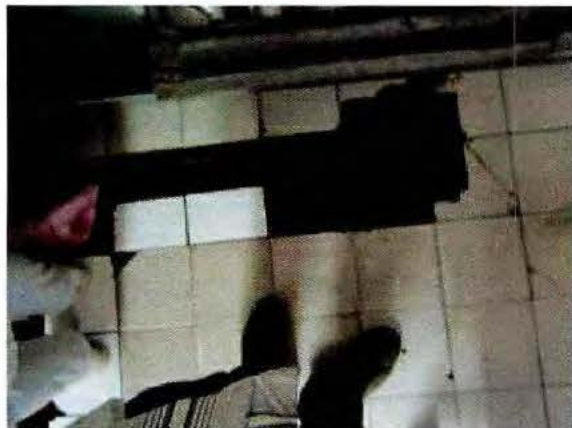
Fotografía N°13: Cerámicos rotos en cocina.
