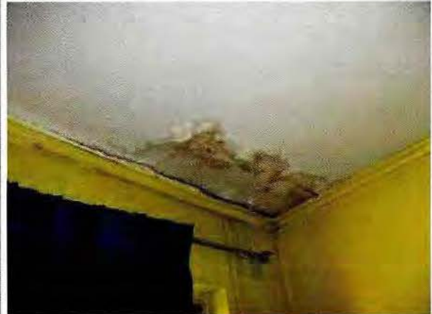
Fotografía N°4: Dormitorio con humedad y moho en cielo, CIP-CRC San Joaquín, 18 de marzo de 2015.
