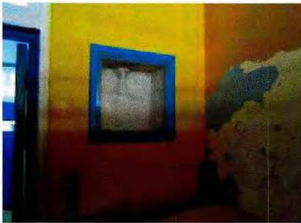
Fotografía N°21: Muros dormitorios casas N°5, con pintura deteriorada.
