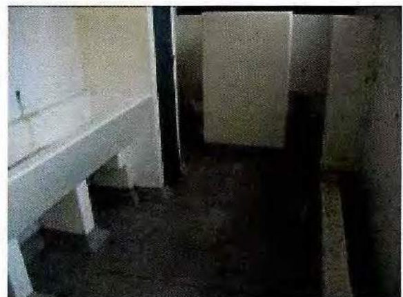
Fotografía N°12: Ausencia de inodoro y grifería lavamanos, en baño sector patio, casa N°7 no utilizada, Centro Metropolitano Norte Til-Til, 23 de marzo de 2015.
