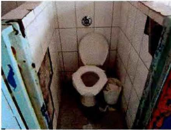
Fotografía N°25: Cerámicos desprendidos en baños casa N°2
