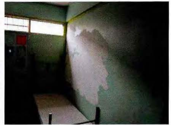
Fotografía N°22: Muros dormitorios casas N°7, con pintura deteriorada.
