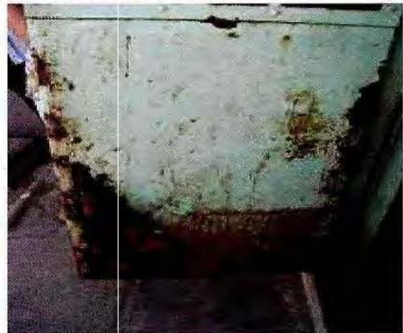
Fotografía N°10: Puertas de habitaciones de unidad de atención especial con altos niveles de oxidación y pérdida de material.
