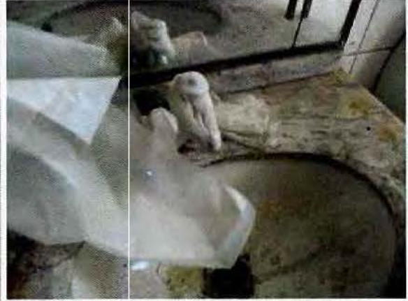
Fotografía N°2: Lavamanos inhabilitado, CIP-CRC San Joaquín, 18 de marzo de 2015.
