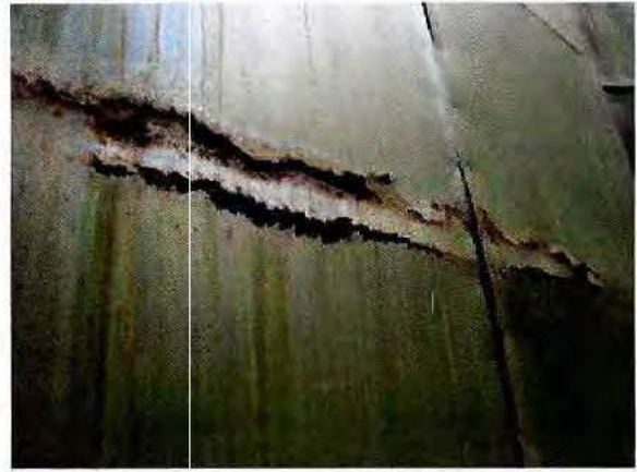
Fotografía N°10: Oxidación en muro perimetral lado exterior en zona oriente.
