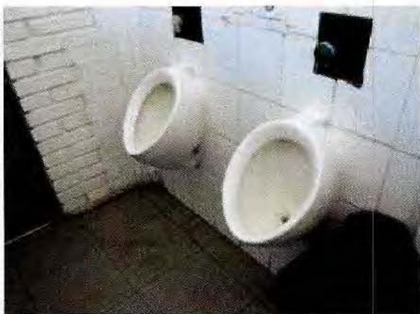
Fotografía N°13: Urinarios de casa N°1 sin funcionamiento, CSC La Cisterna, 30 de marzo de 2015.
