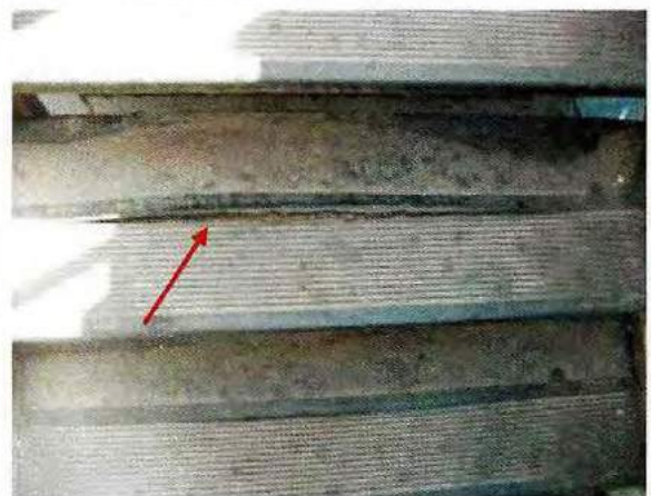
Fotografía N°6: Revestimiento antideslizante desprendido en escalera a dependencias de Gendarmería de Chile.
