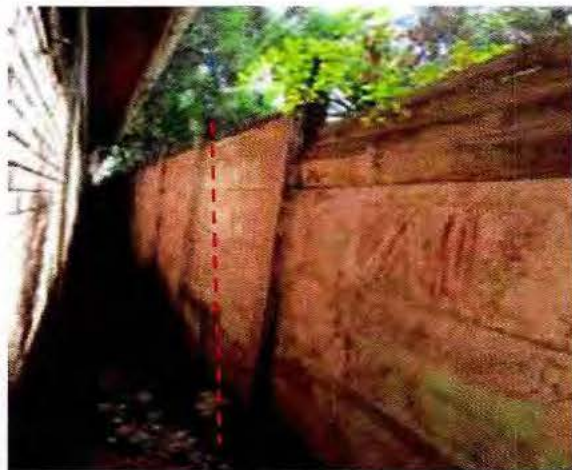
Fotografía N°15: Cierre perimetral oriente detrás de casa N°3 con problemas de estabilidad.
