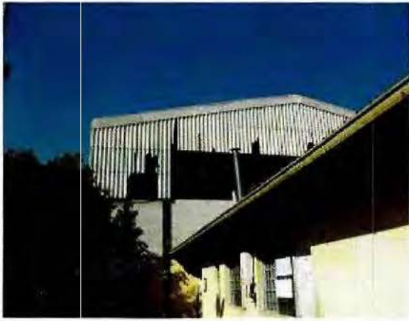
Fotografía N°19: Daño en revestimiento de gimnasio, CIP-CRC Santiago, 31 de marzo de 2015.
