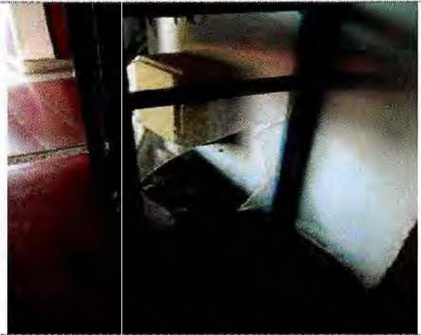
Fotografía N°14: Vidrio roto en puerta metálica de hall de instalaciones para Gendarmería de Chile.
