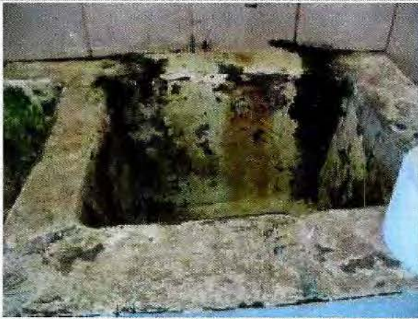
Fotografía N°3: Lavamanos con moho, casa 1, sector patio, CIP-CRC San Bernardo, 16 de marzo de 2015.
