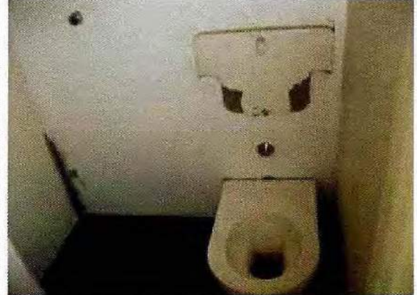
Fotografía N°8: Lavamanos roto en baño no utilizado, casa N°2, Centro Metropolitano Norte Til-Til, 23 de marzo de 2015.
