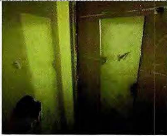
Fotografía N°13: Tabiques rotos en closet dormitorios para Gendarmería de Chile.
