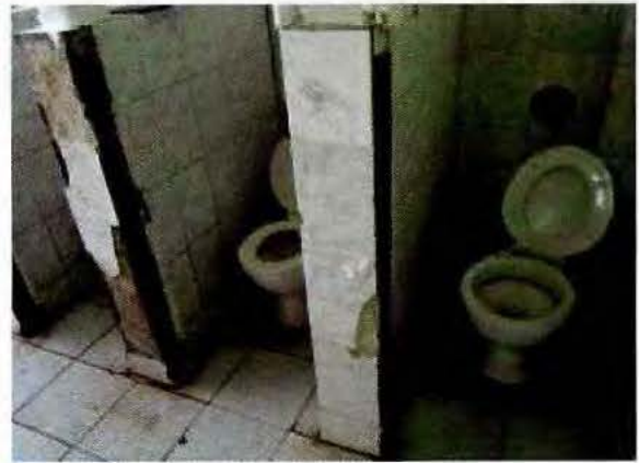
Fotografía N°26: Cerámicos desprendidos en baños casa N°6.
