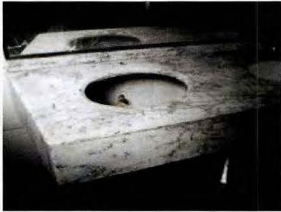
Fotografía N°3: Lavamanos inhabilitado, CIP-CRC San Joaquín, 18 de marzo de 2015.
