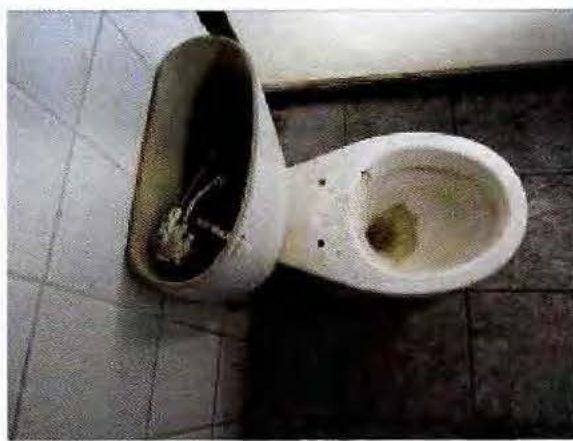
Fotografía N°8: Artefacto en mal estado, CIP-CRC San Joaquín, 18 de marzo de 2015.
