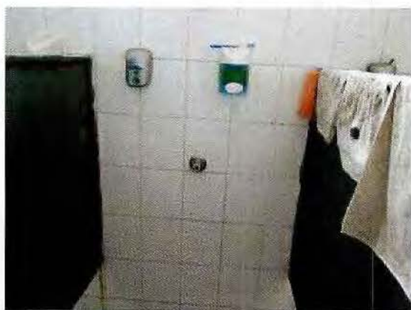
Fotografía N°5: Oxidación en elementos separadores de duchas de jóvenes en casa N°2.
