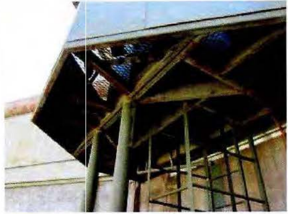
Fotografía N°8: Oxidación en base de garitas.
