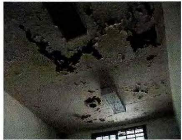
Fotografía N°4: Desprendimiento de pintura en baño de jóvenes varones.
