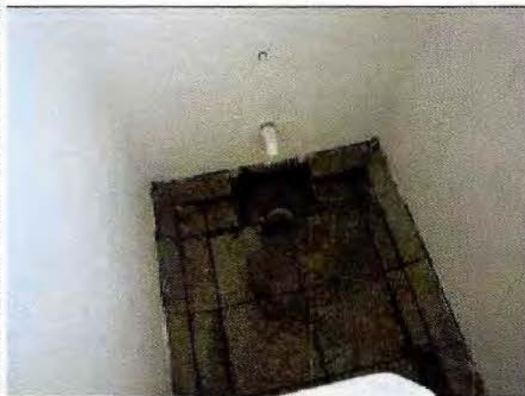
Fotografía N°11: Ausencia de inodoro, sector patio, en casa N°2, Centro Metropolitano Norte Til-Til, 23 de marzo de 2015.
