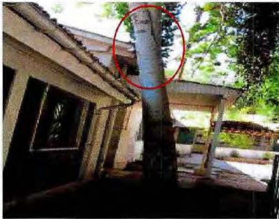
Fotografía N°3: Canaleta casa N°1, destruida por árbol.
