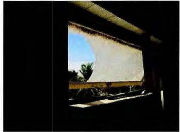
Fotografía N°14: Vidrio roto de ventana baño instalaciones para Gendarmería de Chile, segundo piso.
