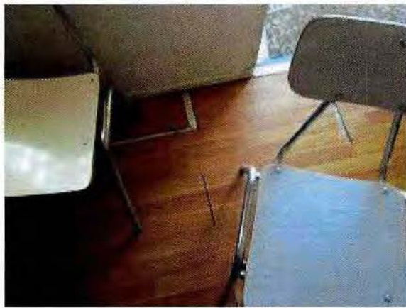
Fotografía N°11: Desprendimiento de piso flotante en módulo de uso educacional.
