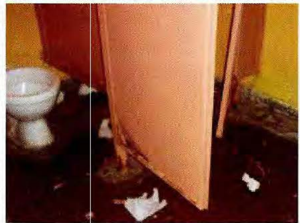
Fotografía N°12: Puertas metálicas de baños comunes casa N°3 con óxido y pérdida de material.
