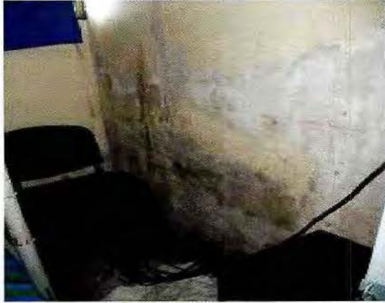
Fotografía N°1: Dormitorio con humedad y moho en pared colindante con duchas de baño, Centro Metropolitano Norte Til-Til, 26 de marzo de 2015.
