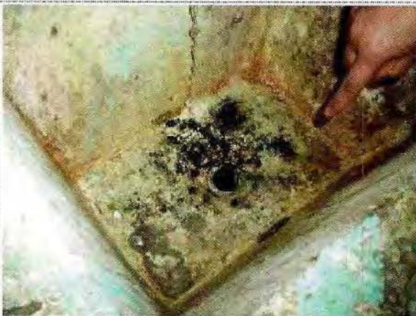
Fotografía N°5: Lavamanos con moho, casa 2, sector patio, CIP-CRC San Bernardo, 16 de marzo de 2015.
