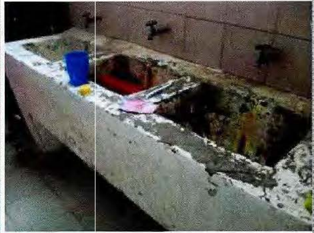
Fotografía N°2: Lavamanos con moho, casa 1, sector dormitorios, CIP-CRC San Bernardo, 16 de marzo de 2015.
