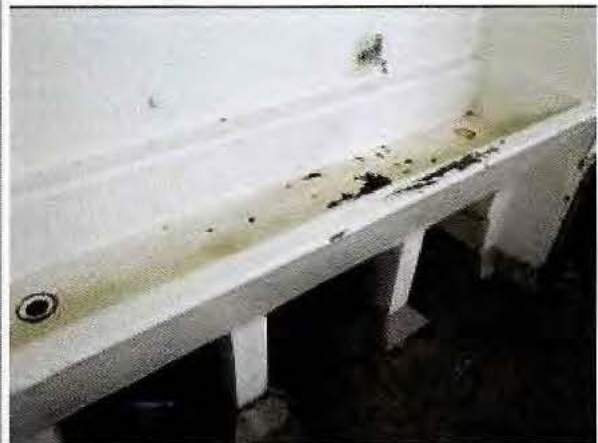
Fotografía N°12: Grifería inhabilitada en baño sector patio, casa N°3, Centro Metropolitano Norte Til-Til, 23 de marzo de 2015.
