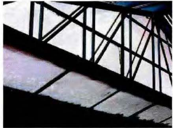
Fotografía N°4: Ventanas sucias en tragaluz sector patio interior casa principal.
