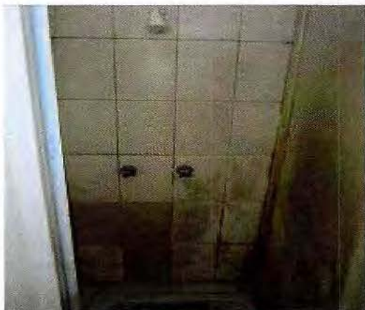
Fotografía N°7: Deficiencia de aseo en ducha y presencia de moho, CIP-CRC San Joaquín, 18 de marzo de 2015.
