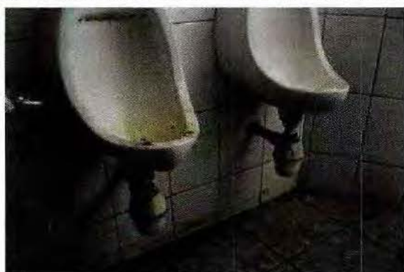
Fotografía N°9: Deficiencia de aseo en urinarios, CIP-CRC San Joaquín, 18 de marzo de 2015.
