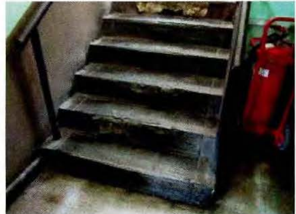
Fotografía N°28: Escalera edificio de Gendarmería de Chile con recubrimiento antideslizante desprendido.
