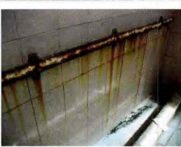
Fotografía N°1: Urinarios con oxido en casa 1, sector dormitorios, CIP-CRC San Bernardo, 16 de marzo de 2015.
