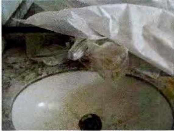
Fotografía N°1: Lavamanos inhabilitado, CIP-CRC San Joaquín, 18 de marzo de 2015.
