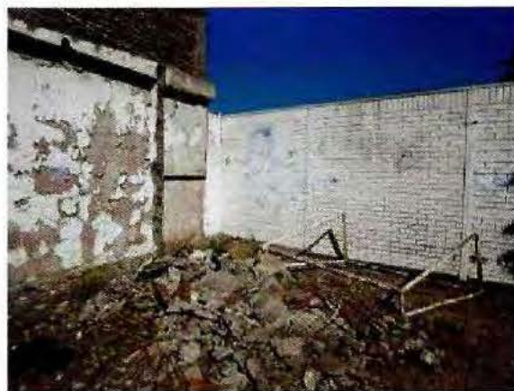
Fotografía N°2: Acumulación de escombros en parte posterior a multicancha.
